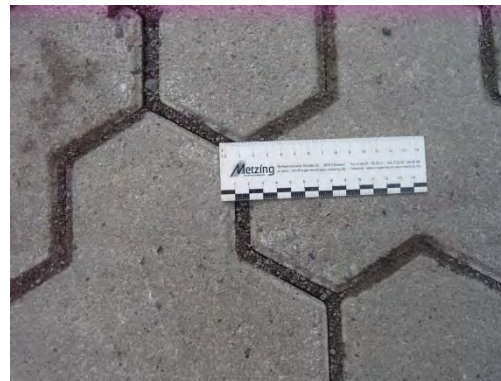
Flankenabriss erkennbar, Steine bewegen sich
